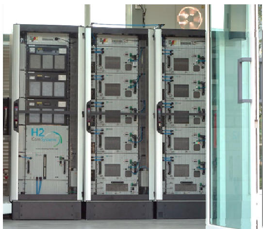
Abbildung 14: Wasserstoffsystem des EGAT Learning Centers
